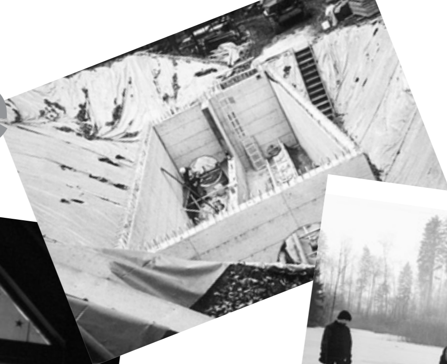
Regenwasser-Sammelbecken zur Entlastung und Optimierung der Kläranlage im Attisholzwald.
